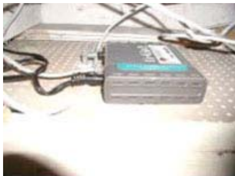
Kuva 14. Tukiasema kattorakenteiden yläpuolella.
